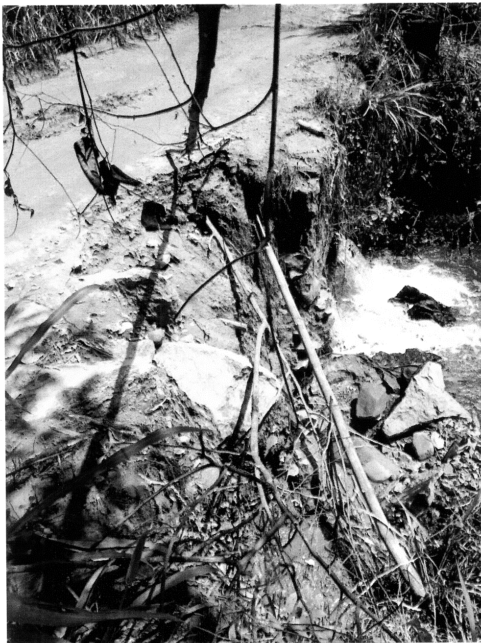
Figura 7 – Início de desmoronamento da ponte próxima a comunidade do Tanque
