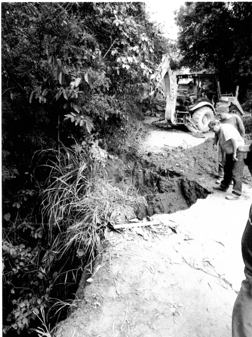
Figura 1 – Desmoronamento da cabeceira da ponte de acesso as comunidades Contendas, Barreiro e Córrego do Paiol
