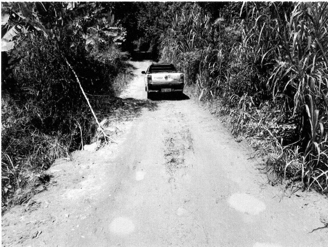
Figura 6 – Início de desmoronamento da ponte próxima a comunidade do Tanque
